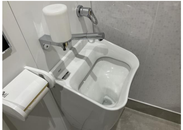
医学部附属図書館バリアフリースイレ内部 オストメイト
