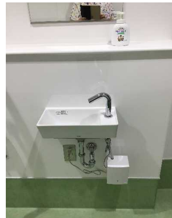
5階多目的トイレ手洗い
