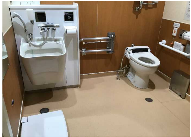
1階多目的トイレ 内部(オストメイト)
