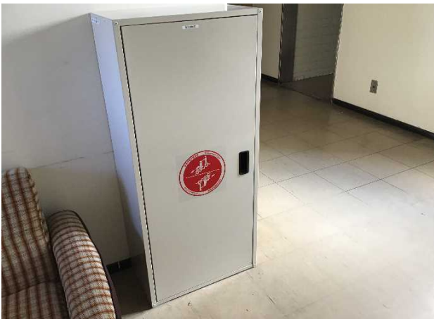
5階 キャリダン(エレベーター前)
