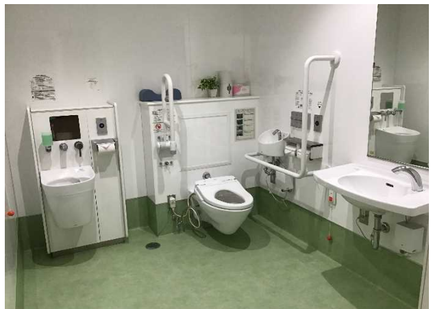
1階 多目的トイレ内部(オストメイト)
