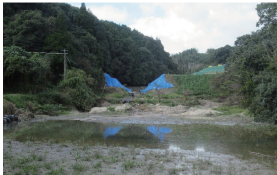
豪雨で決壊したため池
