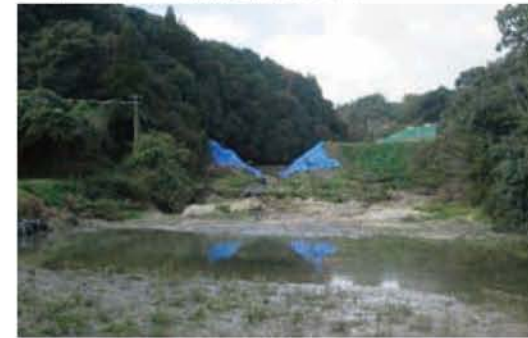
豪雨で決壊したため池
