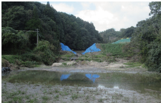
豪雨で決壊したため池
